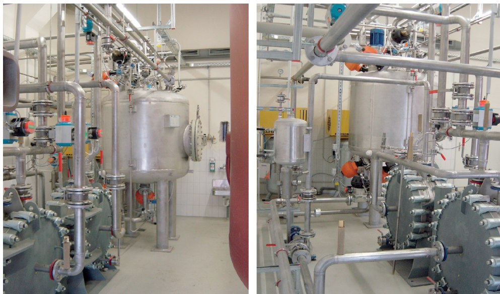
Abb. 7 Die Abwasserdesinfektionsanlage im BSE-Stall: Autoklavenbehälter (Hintergrund) und Wärmetauscher (Vordergrund).
