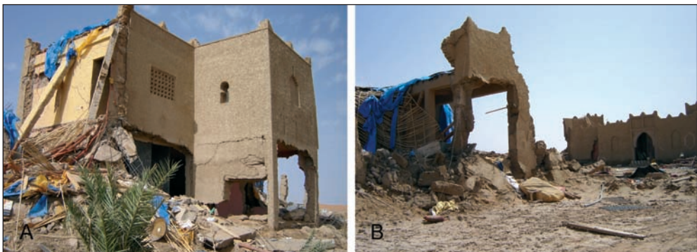
Abb. 9 (A) Eine der besonders stark zerstörten Herbergen ist Riad Maria , die in ihrem Zustand vor der Zerstörung auf Abb. 7 zu sehen ist. (B) Das Baumaterial der ungebrannten Lehmziegel bildete für die Hochwasserflut eine besonders zerstörerische Angriffsfläche: Beispiel der Herberge La Belle Étoile
